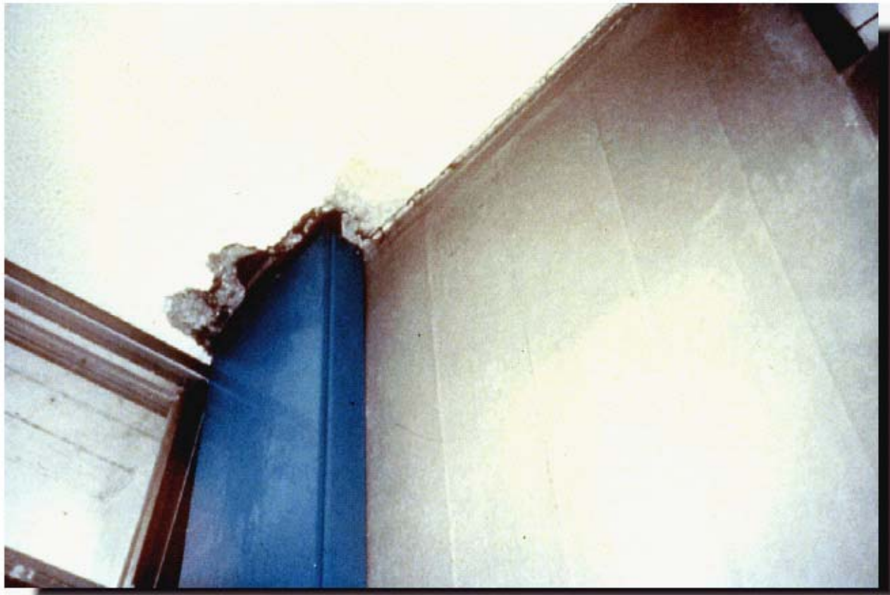
Degrado spontaneo di solaio contenente amianto
